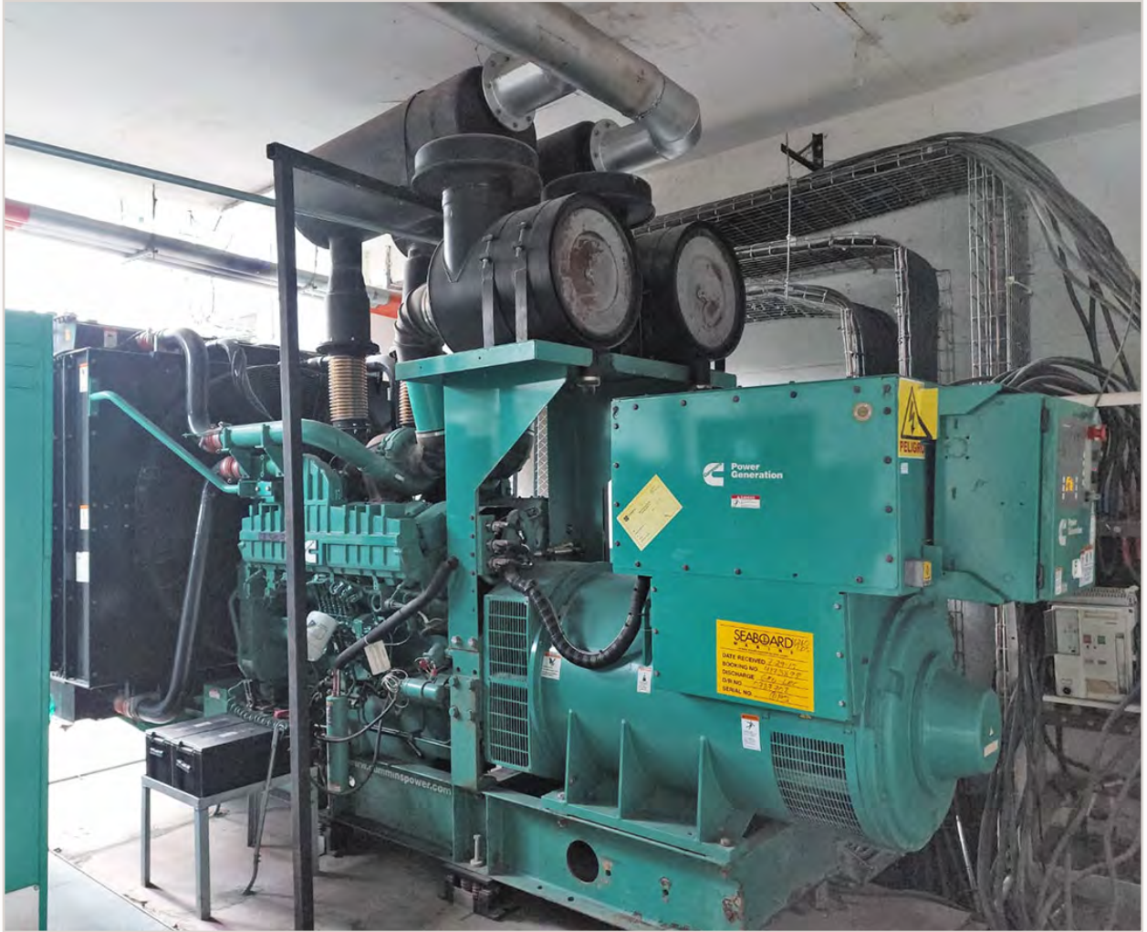
Subestación eléctrica con acciones de mejora por hospital seguro
